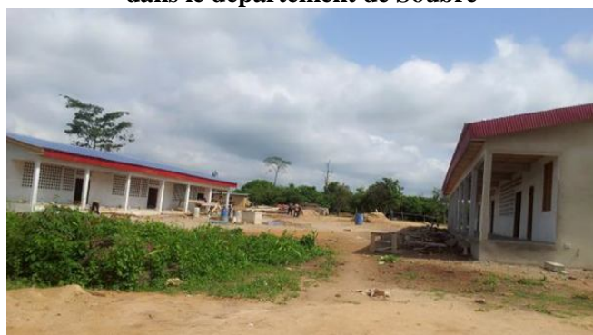
Photo n°7 : Projet V4C : Construction d'une école primaire de 6 classes avec bureau de maître, cantine et latrine à Petit Béoumi dans le département de Soubré
